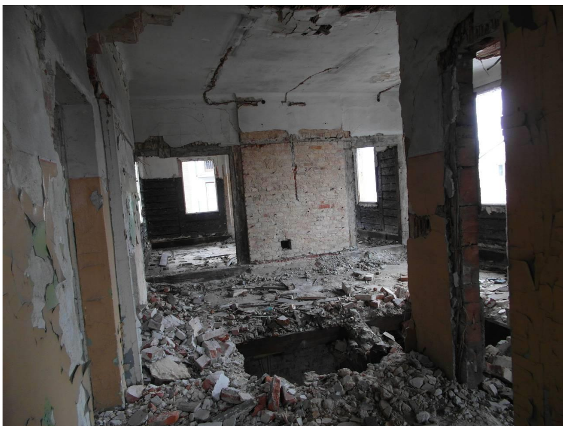
Ilustracja zawalonego stropu nad parterem w południowym skrzydle budynku.
